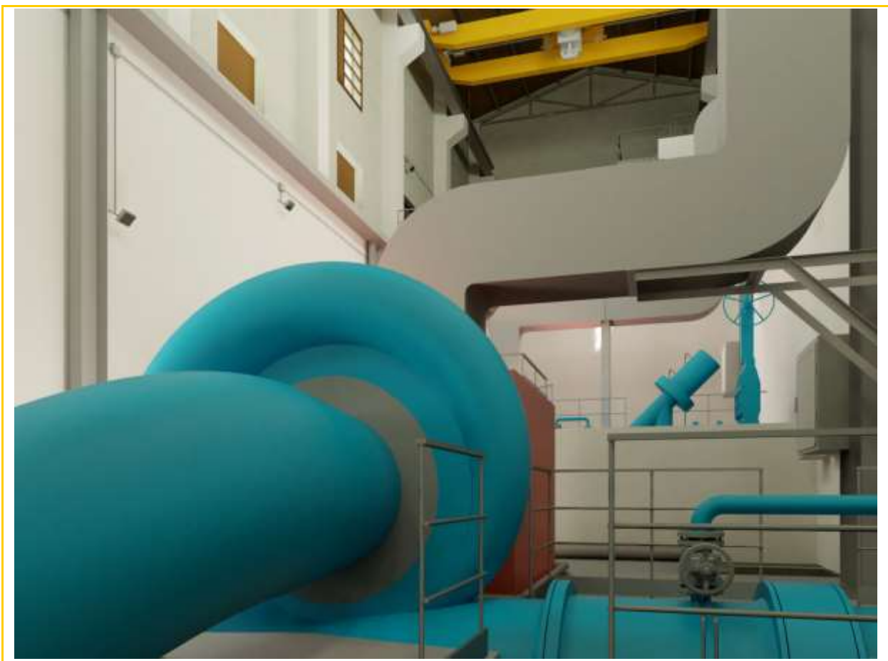
Imagen 6. Válvula y turbina Grupo2. Al fondo válvula de descarga y arriba puente grúa.
