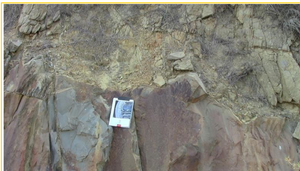
Imagen 10. Zona de alteración irregular, eluvial/coluvial, que recubre el sustrato rocoso. Carretera. de coronación de la Presa.
