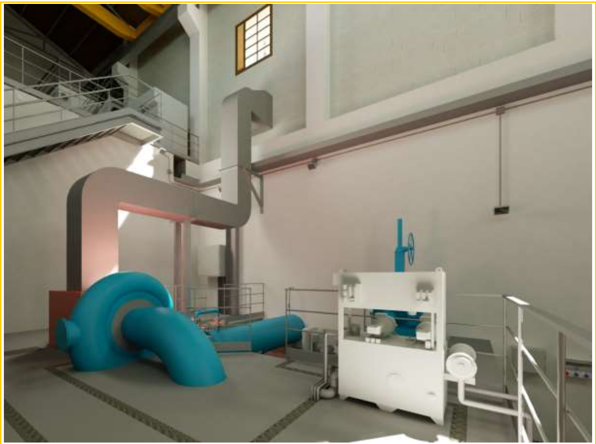
Imagen 7. Válvula y turbina Grupo 1.
