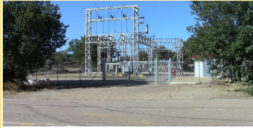
Imagen 45. Subestación Eléctrica Fuenteguinaldo.
